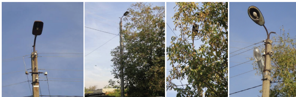
Figura 11. Elemente ale fostului sistem de iluminat stradal
